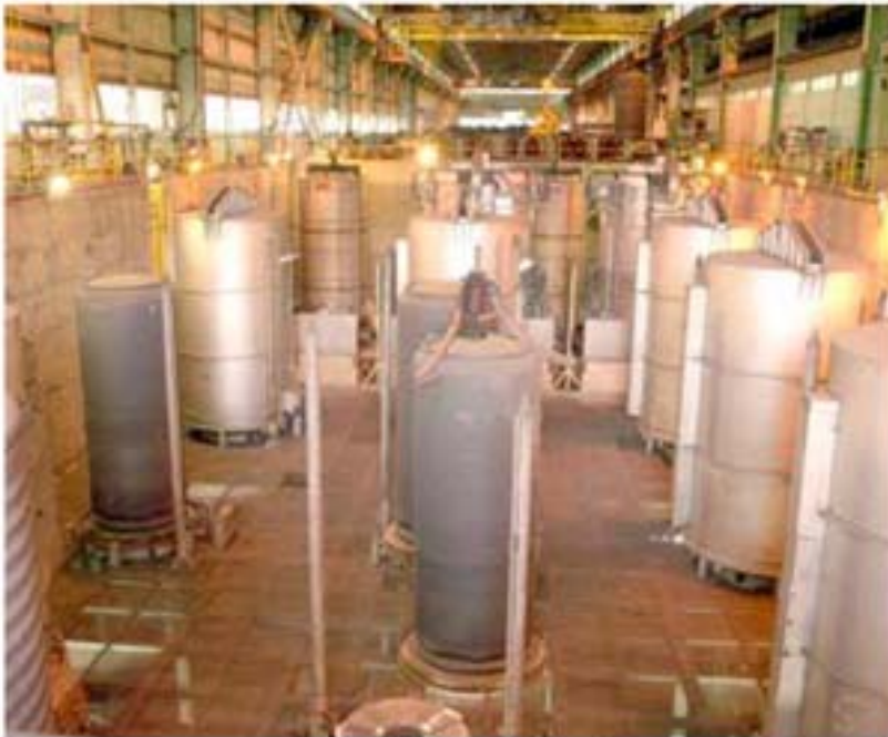
Figura 4.6 – Foto das bobinas sendo processadas em bateladas nos fornos de recozimento em caixa.
